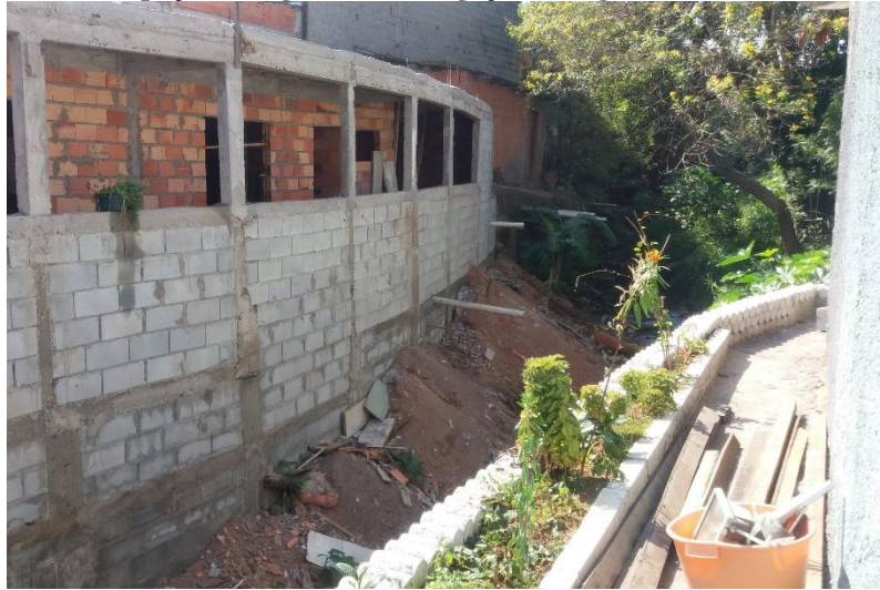
Figura 23 – Ocupações irregulares com ligação de esgoto diretamente no córrego.
