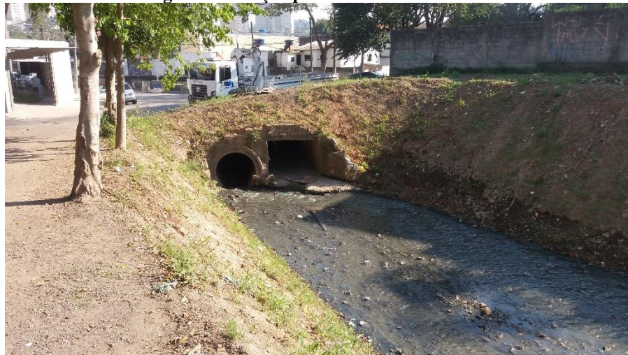
Figura 51 – Seção problemática - montante.
